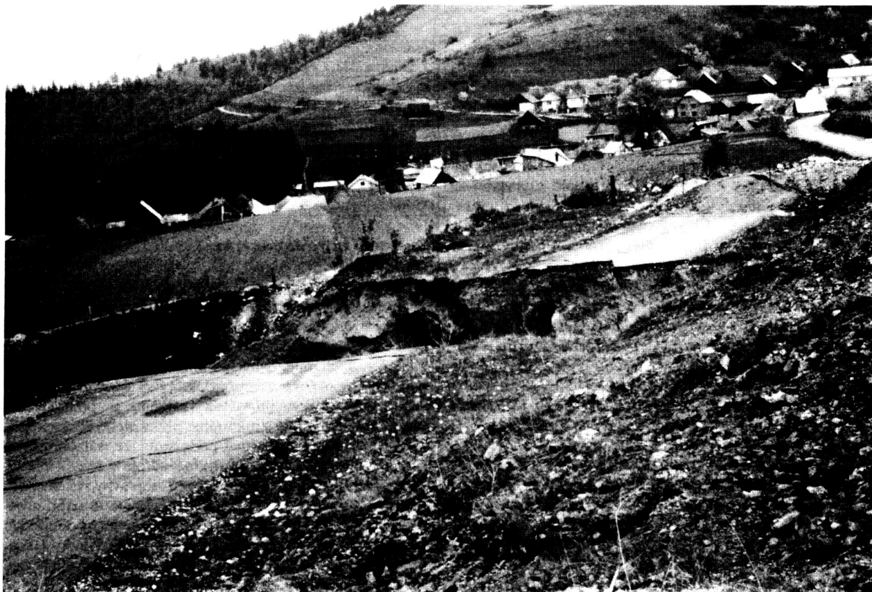
Pásmo trhlín na štátnej ceste Rudňany-Poráč
