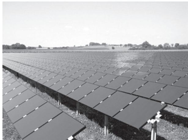
6. Slnečná elektrárňa s výkonom 1,5 MW p vo Wiedersbachu (Nemecko). Foto: IBC Solar AG
