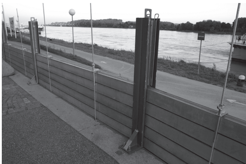
Protipovodňové zábrany na Dunaji (Krems). Foto: R. Špaček, 2007
