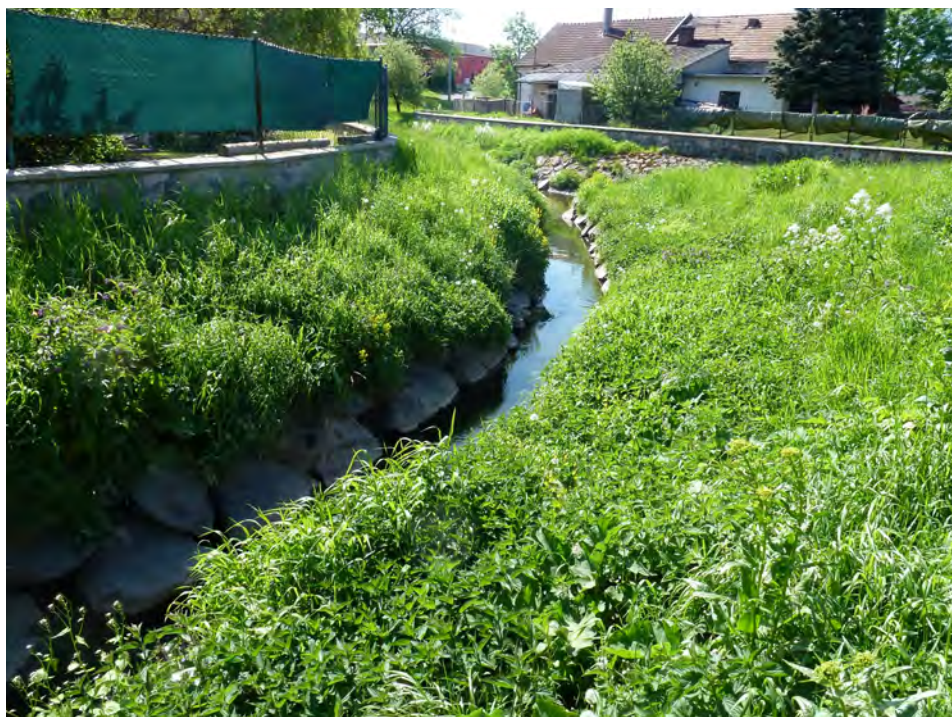
Obr. 2. Koryto řeky Svitavy u soutoku s Ostrým potokem zpevněné kamenným záhozem (2013). Foto: Eva Svobodová
